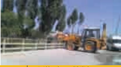
İnşaat atıkları dereye dökülürken (uygun olmayan bir davranış örneği)
